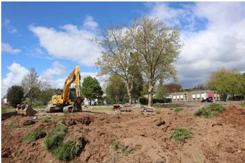
Les travaux de terrassement ont débuté mi-avril sur le site de l'école Charlie-Chaplin.
